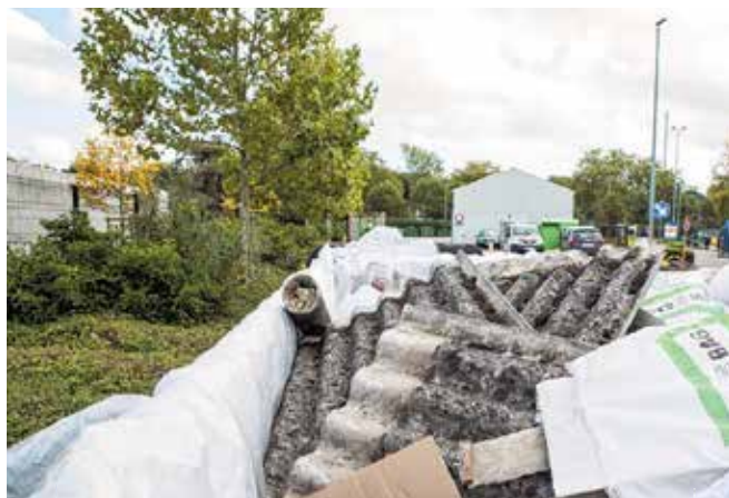
In Brugge ligt het asbest op het zeil dat het normaal moet afdekken. (foto KW)
