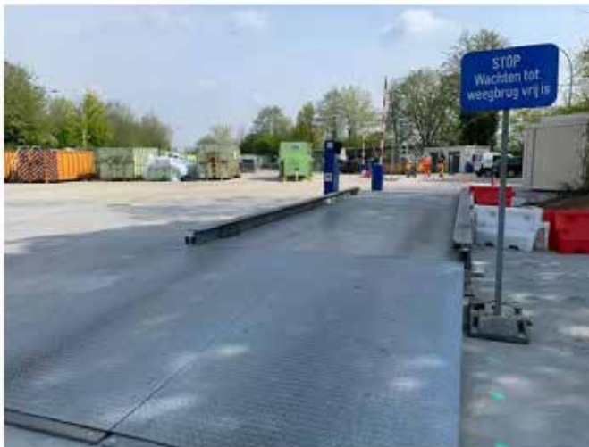
Er zijn weegbruggen geïnstalleerd © stad Kortrijk
