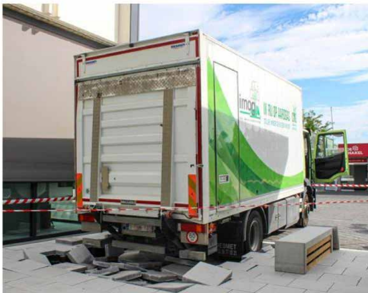
De chauffeur was niet op de hoogte dat de nieuwe vloer niet geschikt is voor zwaar verkeer. © JONATHAN FOLENS
