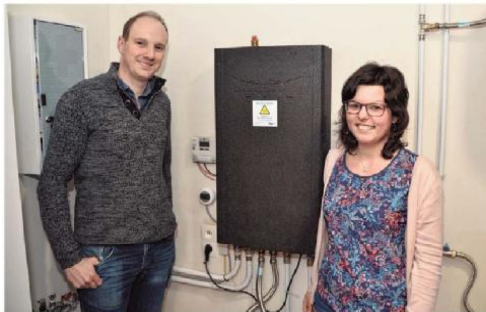
De woning van Thibaut Terrie en Debby Dequesne wordt verwarmd met restwarmte. (Foto BRU)
